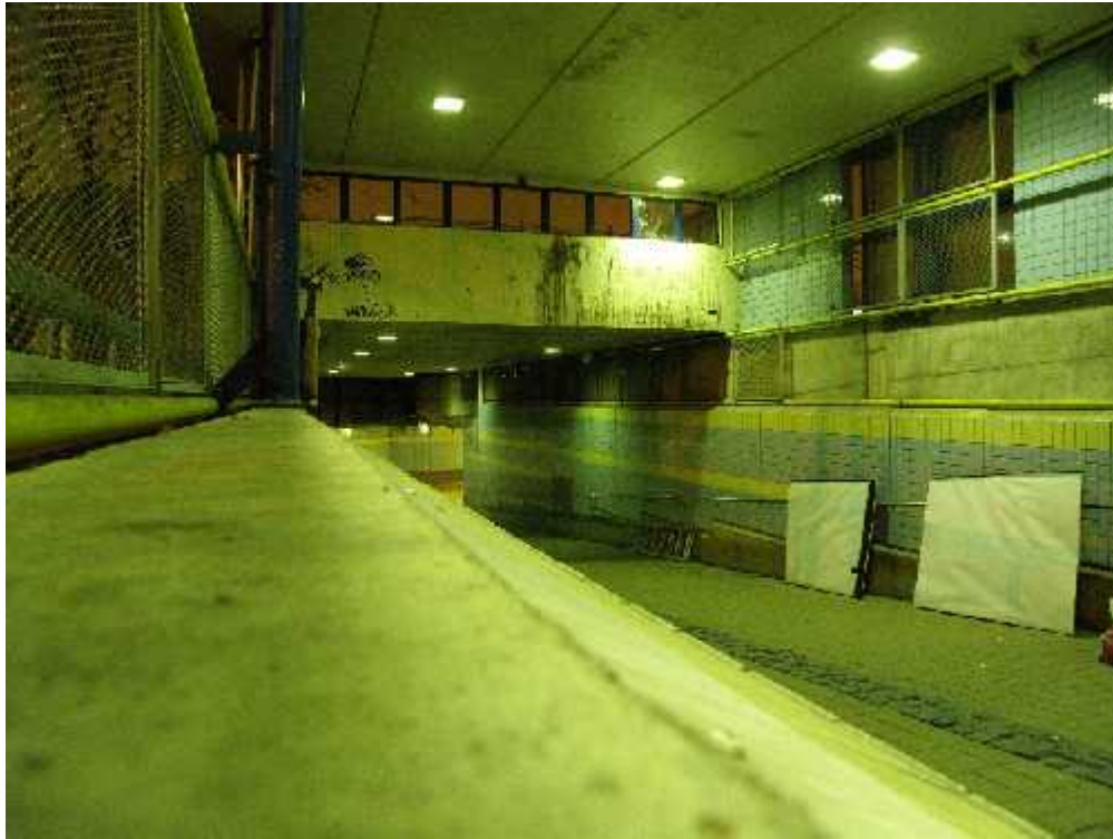
Aseman alikulun palkki on töhryinen
